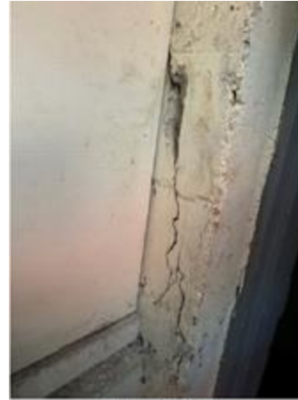
Fissure côté Ouest
