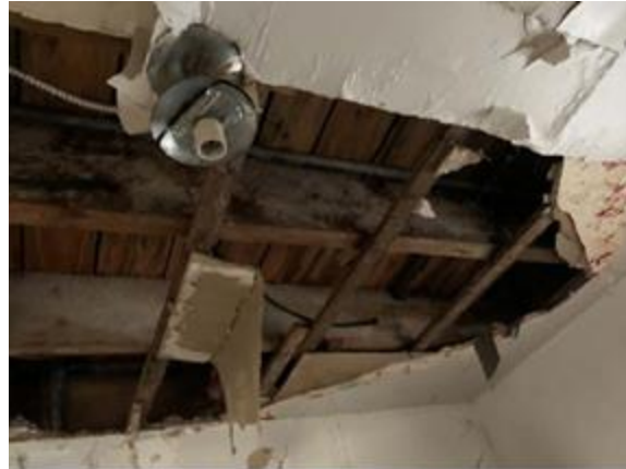
Moisissure et fatigue sur la structure
