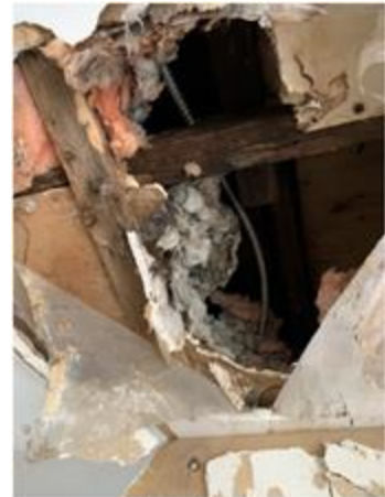
Moisissure sur la structure
