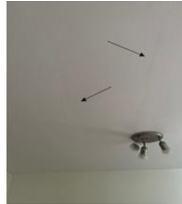
On perçoit l'espacement dans la structure du plafond dû à des problèmes d'entretien avec les composantes structurales. En outre, la présence d'humidité élevée dans la cavité du plafond/plancher.
