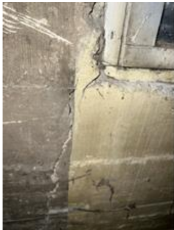
Fissure importante du mur de fondation
