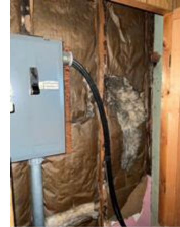
Isolation humide près du panneau électrique
