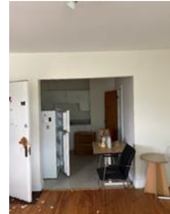
Courbure du plafond et ouverture non nivelée. Toit partiellement en pente.
