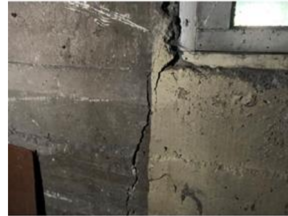
Fissure côté Ouest
