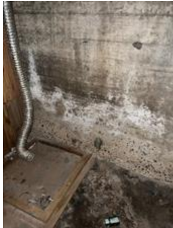
Interface mur-sol, détérioration du béton
