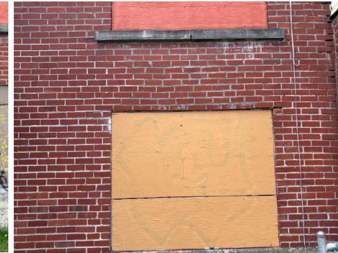
3-Linteau corrodé et en déflexion
