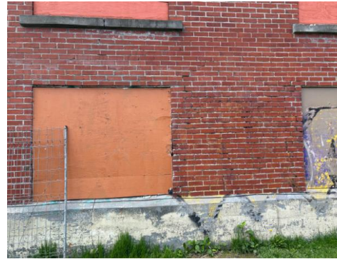
1-Fissure au-dessus fenêtre en façade avant
